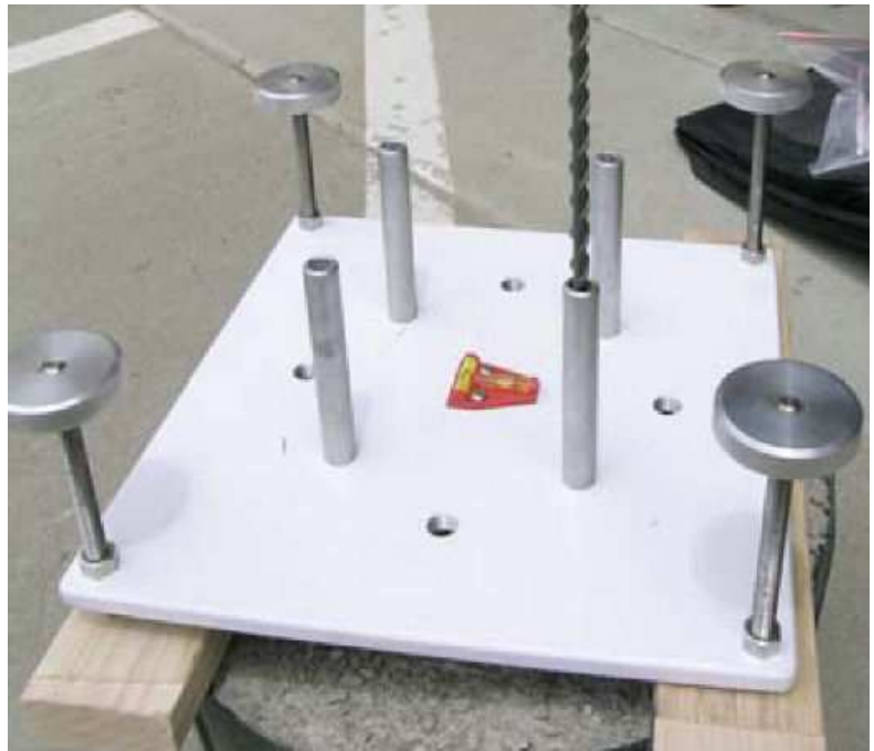
Figura 61: guida per i fori su roccia da realizzare per l'installazione del GPS MAST .
