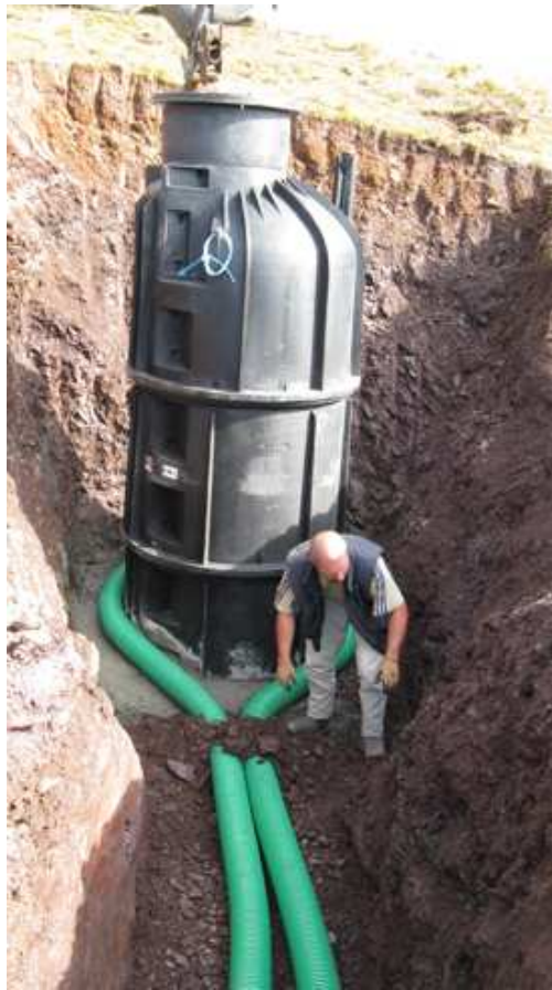
Figura 1.11: Serbatoio in polietilene e sistema di drenaggio (tubi verdi) utilizzati per la stazione ZOU2.
