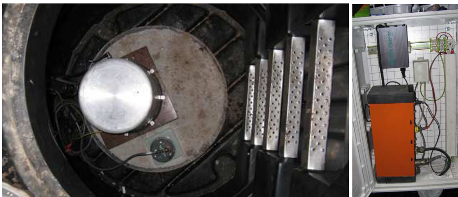
Figura 1.12: Alloggiamento dei sensori (sx) e dell'acquisitore (dx) presso la stazione ZOU2.
